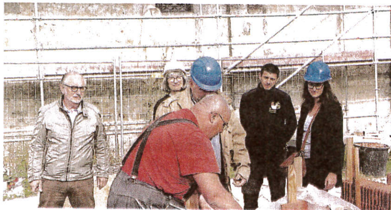
Réunion de chantier entre Benoît Maffre ; Dominique Ragot, maire ; la société Restauration travaux Normandie et la société Cruard charpente. L'atelier Vitraux d'art Forfait a restauré plusieurs vitraux.
