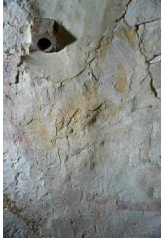
Vue générale du pendentif sud-ouest en lumière tangentielle montrant la surface tourmentée de l'enduit appliqué sans traitement d'aplanissement.
