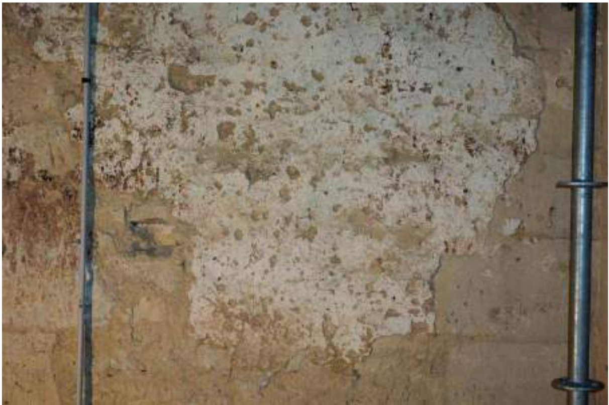
Vue générale de la partie inférieure du mur nord où les petites lacunes sont particulièrement denses
