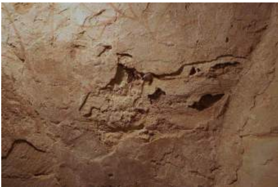
Décollements importants au niveau des deux enduits et de la maçonnerie, de la partie supérieure du pendentif nord-ouest – éclairage tangentiel
