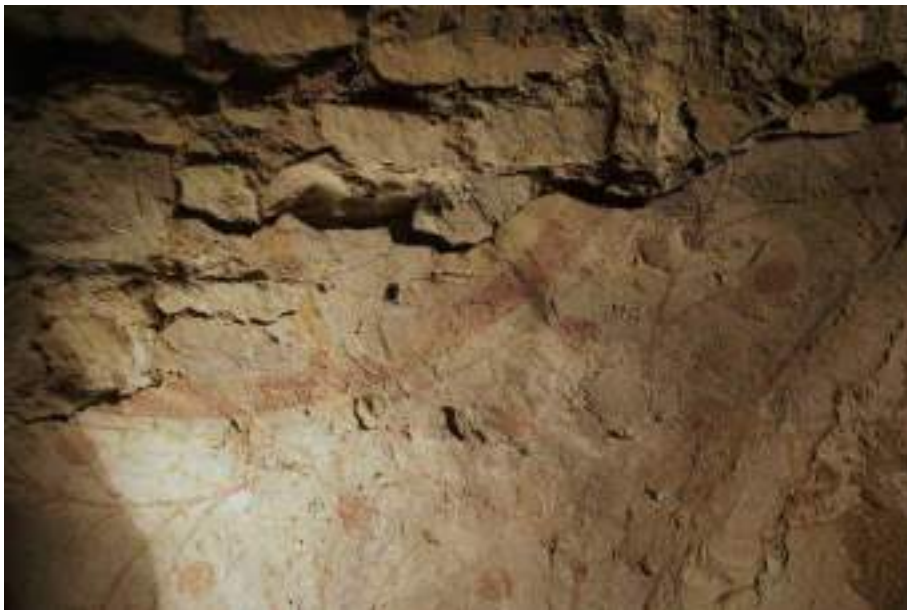
Décollements importants de la partie supérieure du pendentif nord-ouest – éclairage tangentiel
