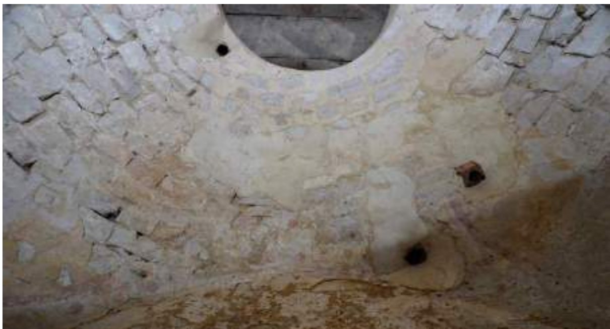
Vue générale de plage d'enduit jaunâtre très dur, appliqué sur la coupole, côté sud
