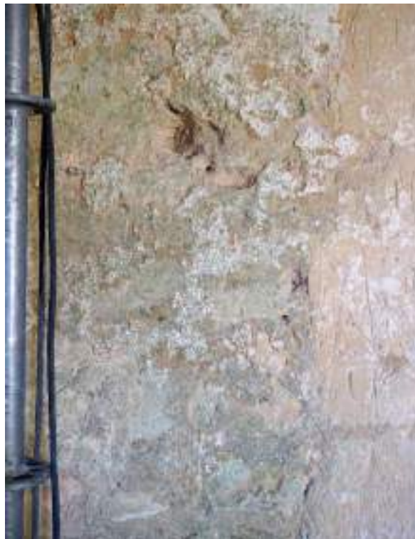
Colonies d'algues et de lichens sur le mur nord, côté ouest
